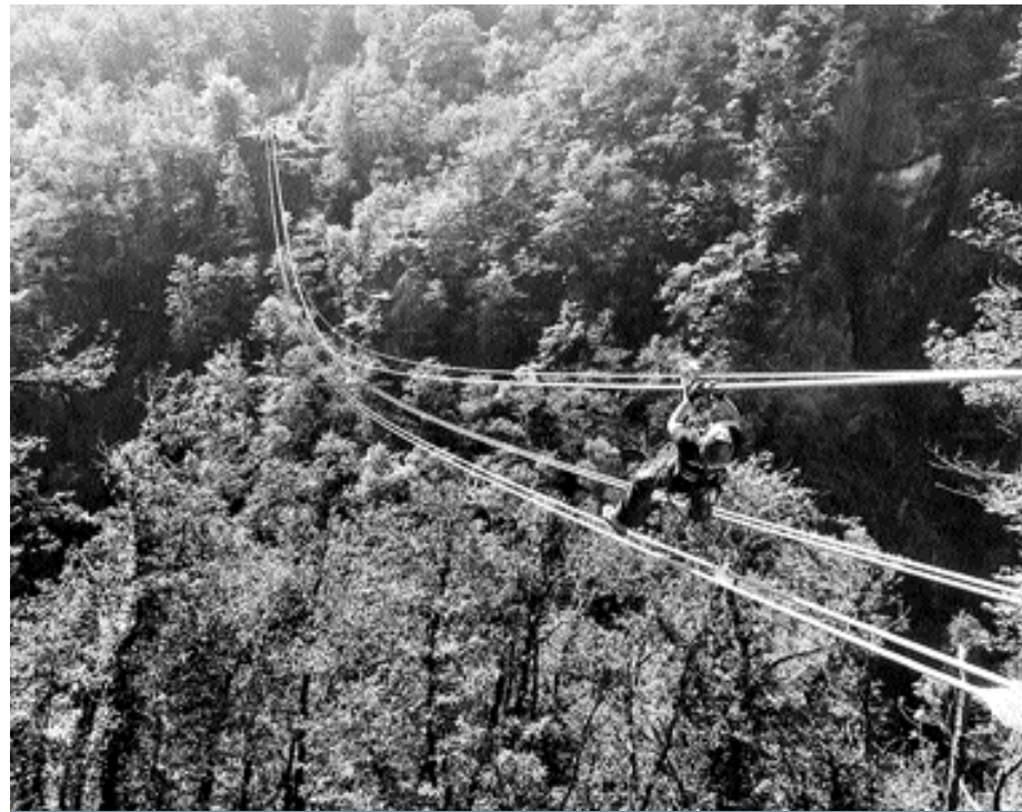
Das ist Spannung pur: Das Spannen der Stahlseile für die tibetische Brücke
